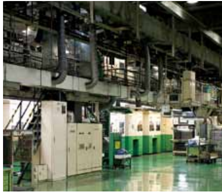
中日新聞本社地下の印刷工場
